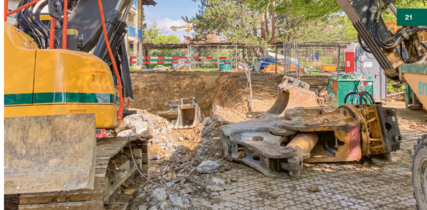
Der Abbruch der alten Garage konnte durch unseren gut ausgestatteten Fuhrpark mit dem 23-Tonnen-Volvo-Raupenbagger erledigt werden.
