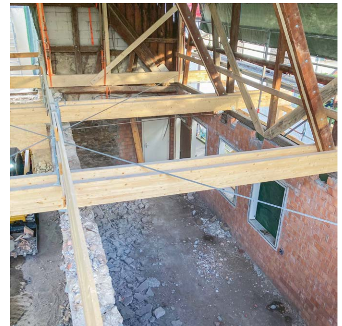
Unter grossformatigen und aufwändigen Abfangungsmassnahmen wurden die historischen Deckenbalken von der Zimmerei nach erfolgtem Rückbau wieder eingebaut.
