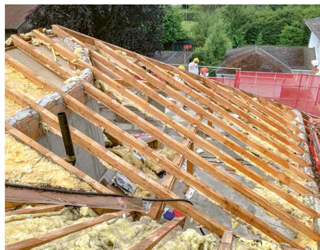
Im Aussenbereich wurde das komplette Satteldach abgebrochen und durch ein Flachdach ersetzt.
