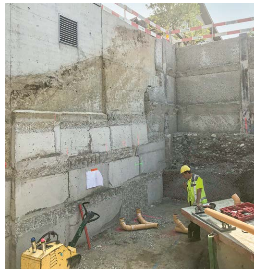
Es mussten mächtige Stahlträger im Erdreich verankert werden, um die direkt oberhalb der Baustelle liegende Quartierstrasse zu sichern.
