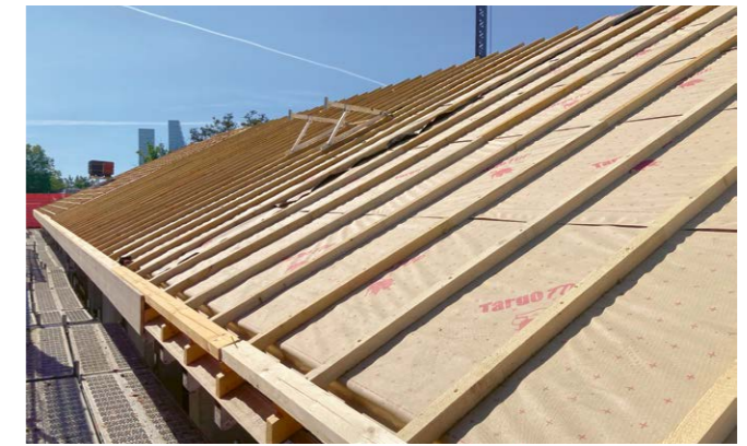
Als Dampfbremse und mechanischer Schutz der Dämmung wurden vollflächig verlegte OSB-Grobspanplatten eingesetzt.
