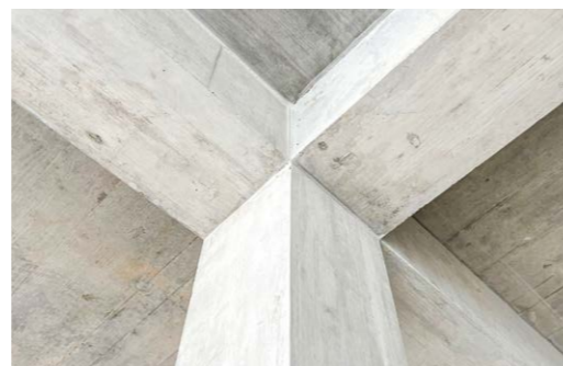
Als Abschluss des jeweiligen Stockwerks wurden die Sichtbetondecken auf die Sichtbetonstützen und Unterzüge geschalt und betoniert.
