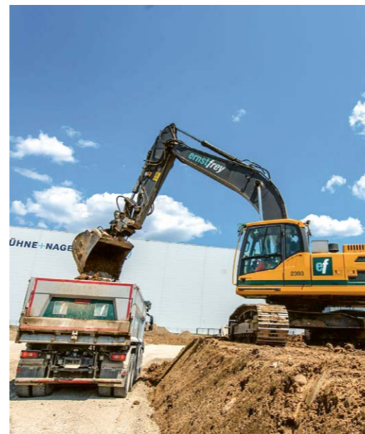
Aufgrund des sportlichen Terminprogramms musste der Abtrag in kürzester Zeit und höchst effizient von unseren Maschinisten vollzogen werden.
