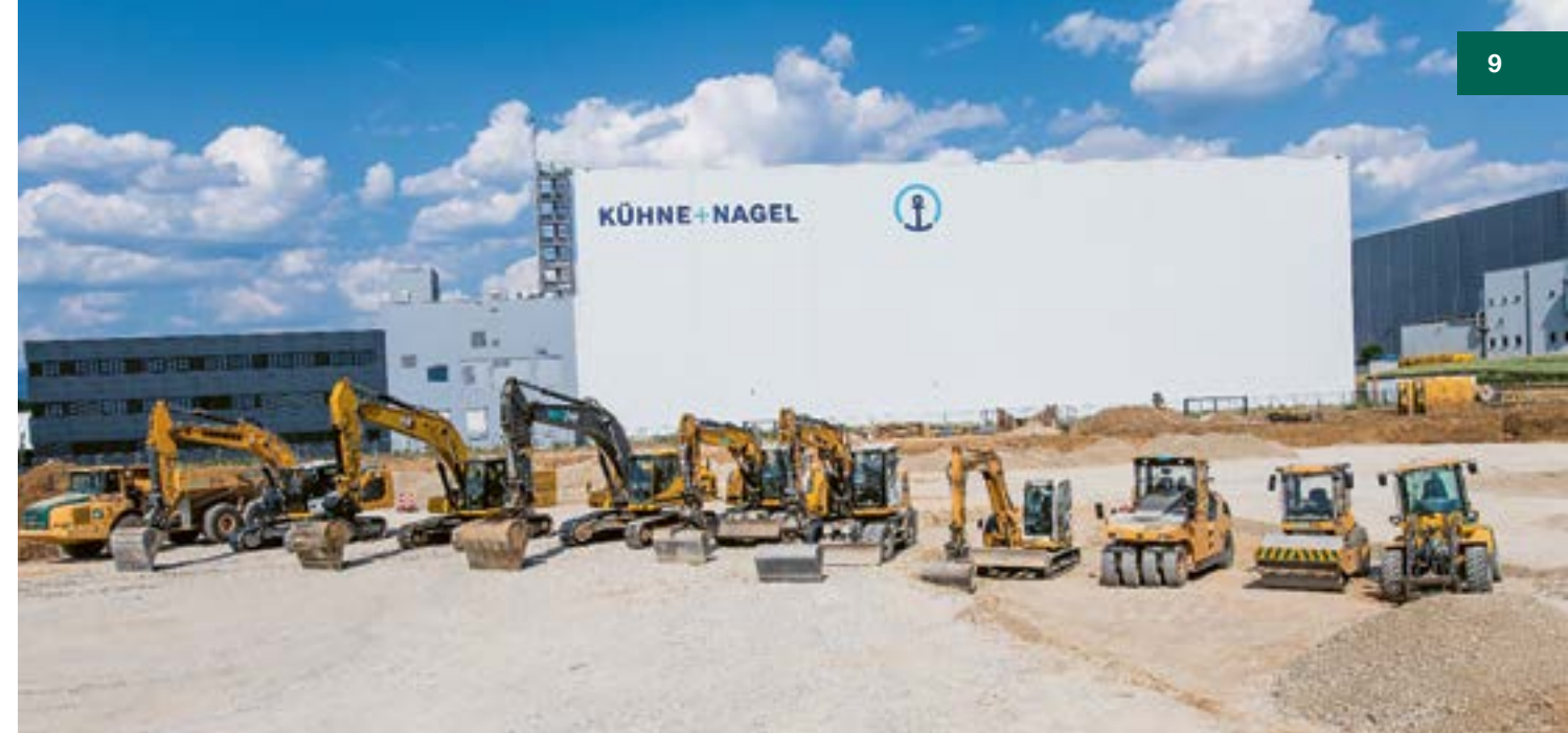
Für die Abtragungsarbeiten des Oberbodens (ca. 7000m 3 ) und den Aushub (ca. 50 000m 3 ) brauchte es viele Maschinen.
