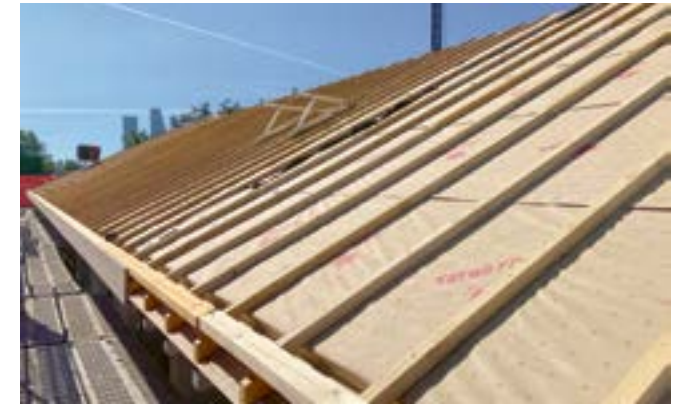
Als Dampfbremse und mechanischer Schutz der Dämmung wurden vollflächig verlegte OSB-Grobspanplatten eingesetzt.
