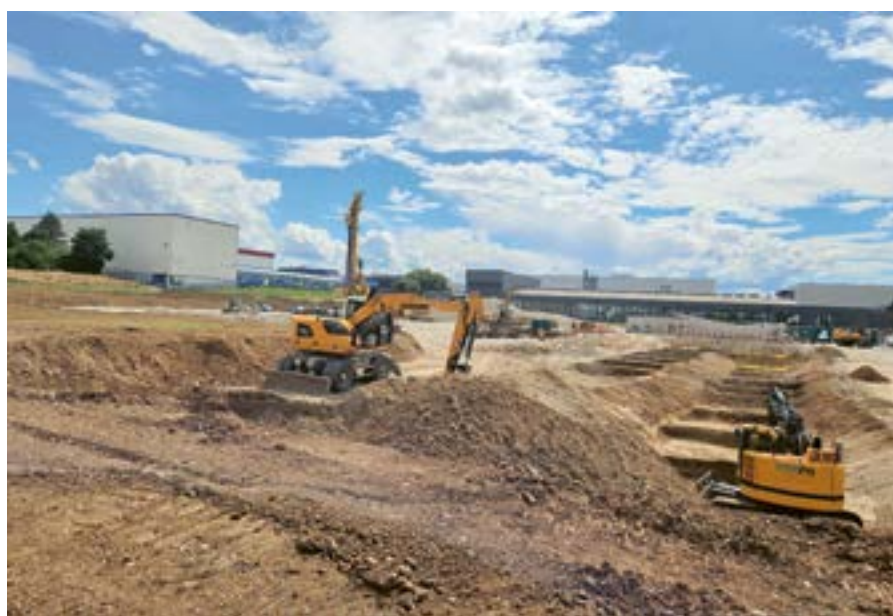
Der Untergrund musste mittels Betonfundamenten und einer Koffering realisiert werden, um die Tragfähigkeit zu gewährleisten.
